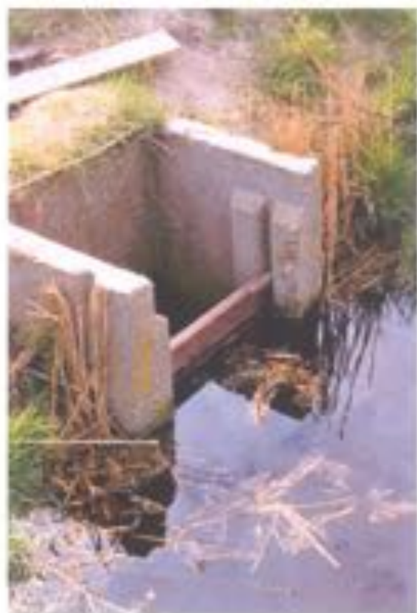
Met behulp van kleine stuwtjes wordt het water in de perceelsslotten op een hoger peil gehouden dan de hoofdvaart.
